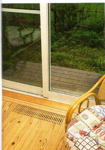
室内の温（冷）風噴出口
