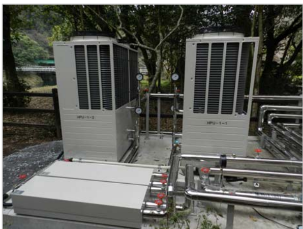
【空冷ヒートポンプ】
